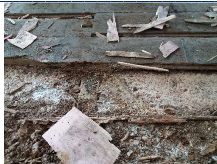
Piso de madeira com cupins
